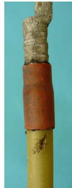
Kabeļa paraugs ar eroziju
